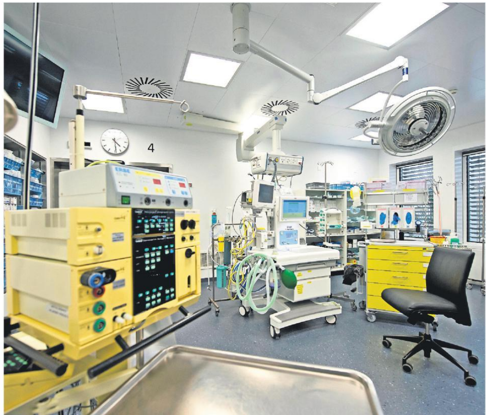
Einer der vier Operationssäle in der neuen Augenklinik des Luzerner Kantonsspitals:
